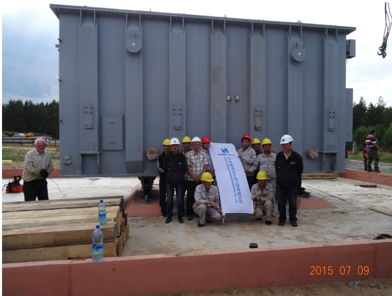
斯莫尔贡变电站主变就位
