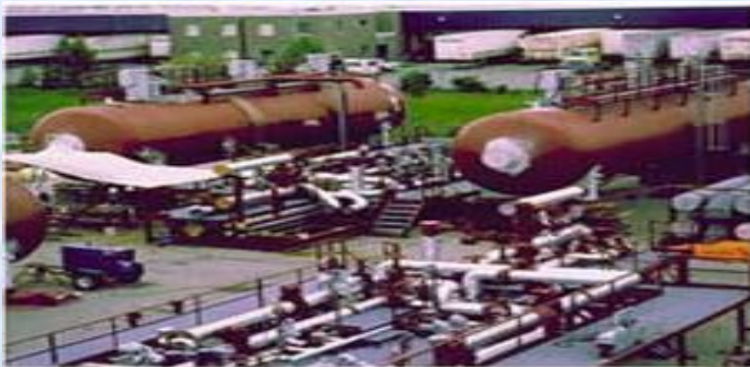
Рис.2. Электрообессоливающая установка фирмы Aker Kvaerner
