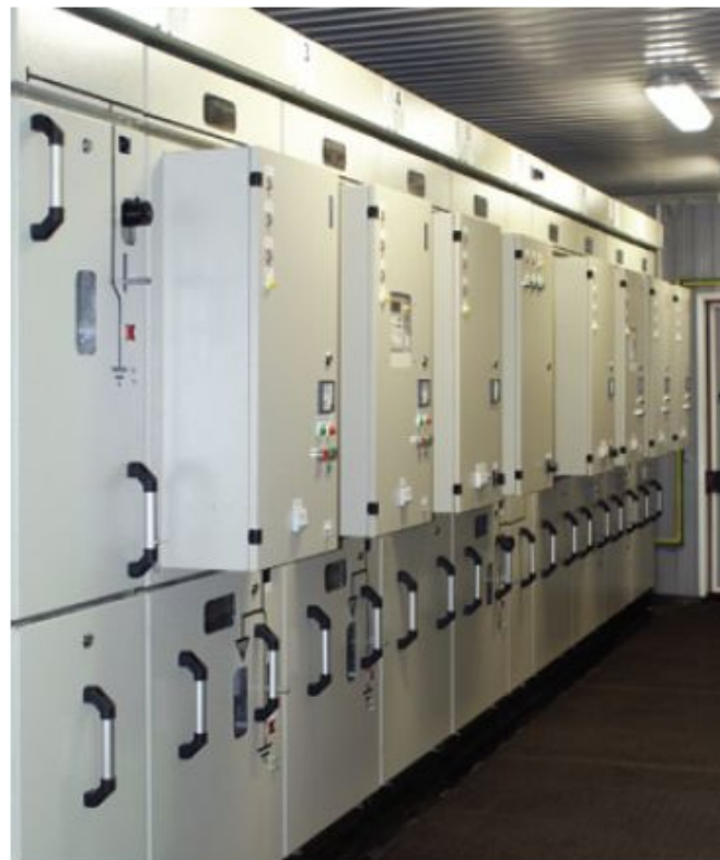
РУ 6(10) кВ, выполненное на базе КСО «Новация»
