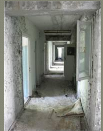
Разрушенные здания представляют опасность
