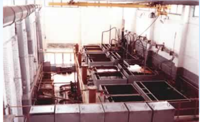
•Станция нейтрализации сточных вод
