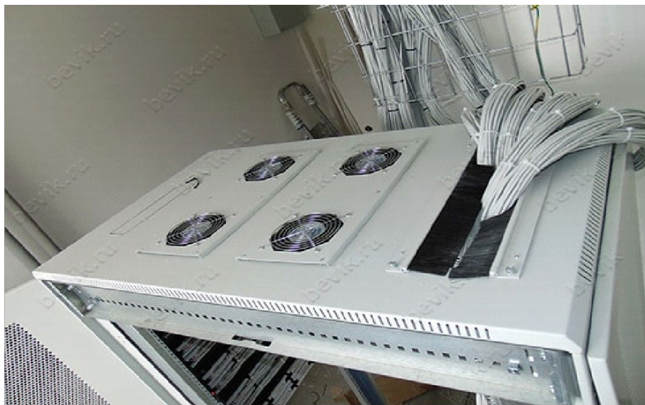
Рисунок 4. Щетки для кабельных вводов шкафов
