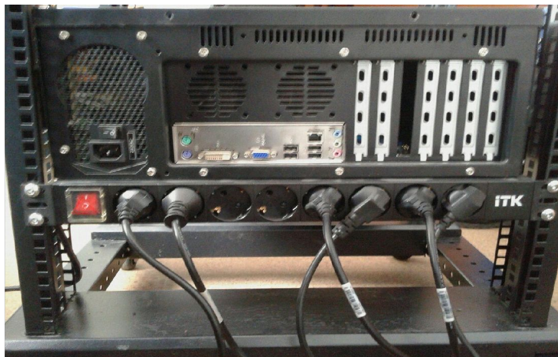
Рисунок 7. Сервер, установленный на сетевой фильтр
