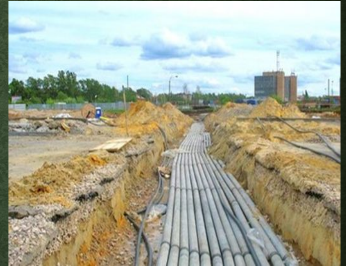
Волоконно-оптическая линия связи
