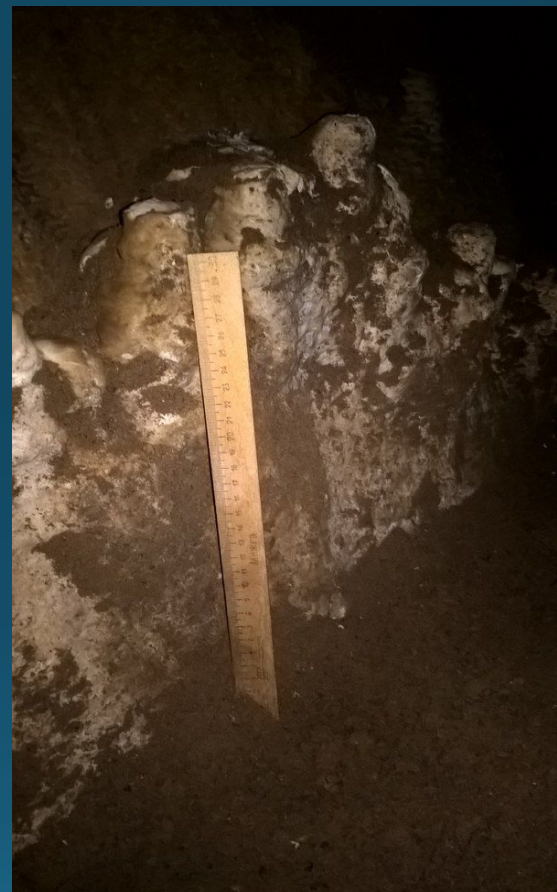
Сталагмиты на обрушенном блоке потерны
