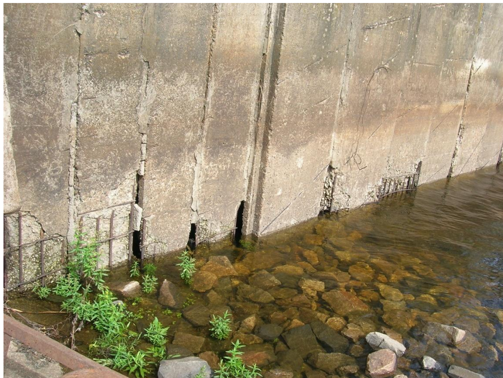
Рис. 6. Пошкодження залізобетонної стіни на вході до ковша №1
