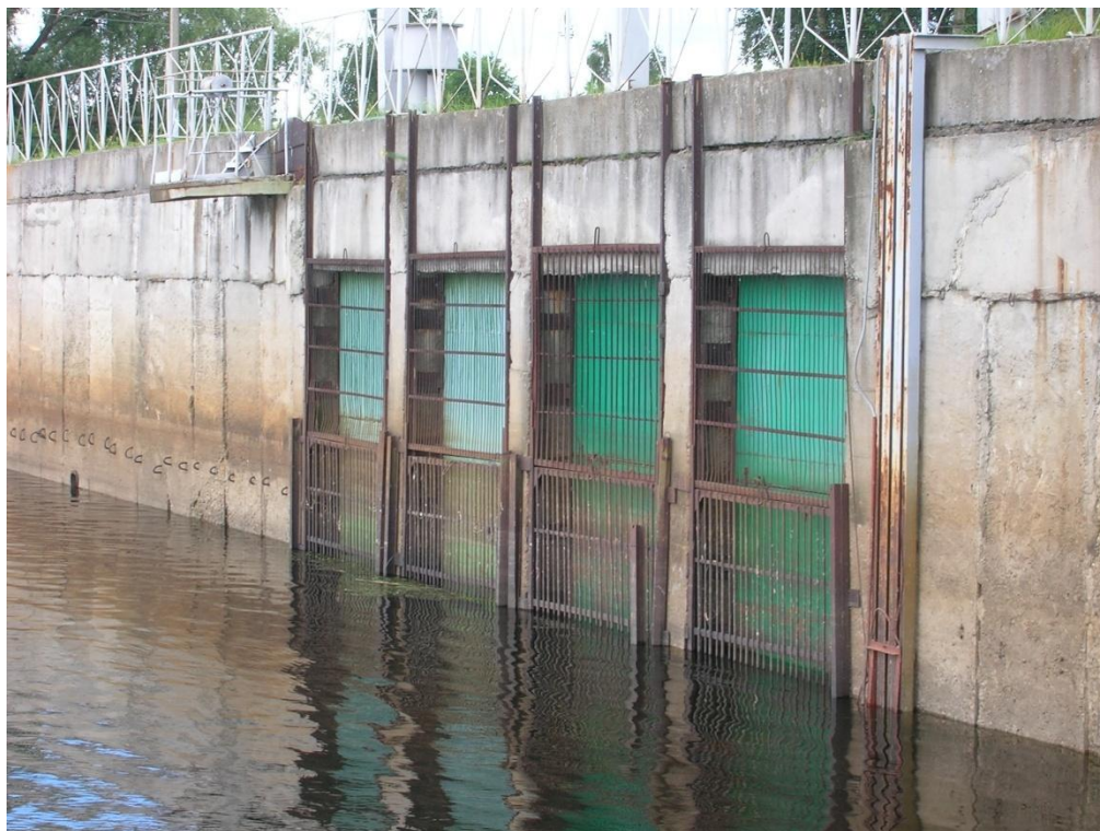
Рис. 9. Вхідна частина водозабірної ковша №2
