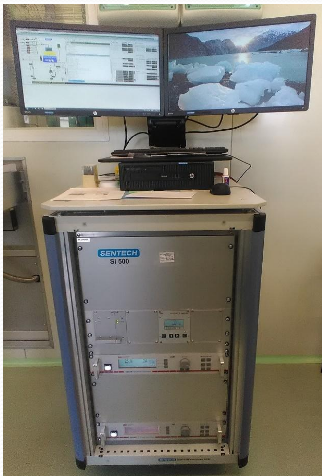
Установка Sentech SI 500
