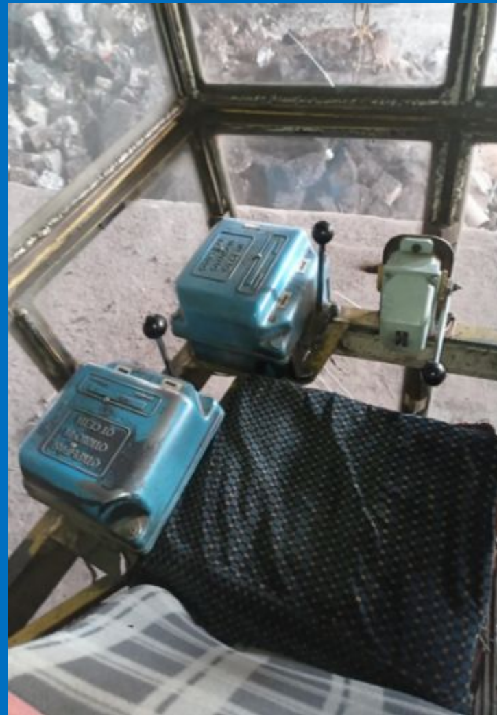
Кран мостовой электрический магнитно-грейферный
