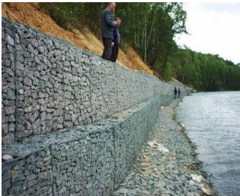
Рис. 1. Вдольбереговые подпорные стенки.
