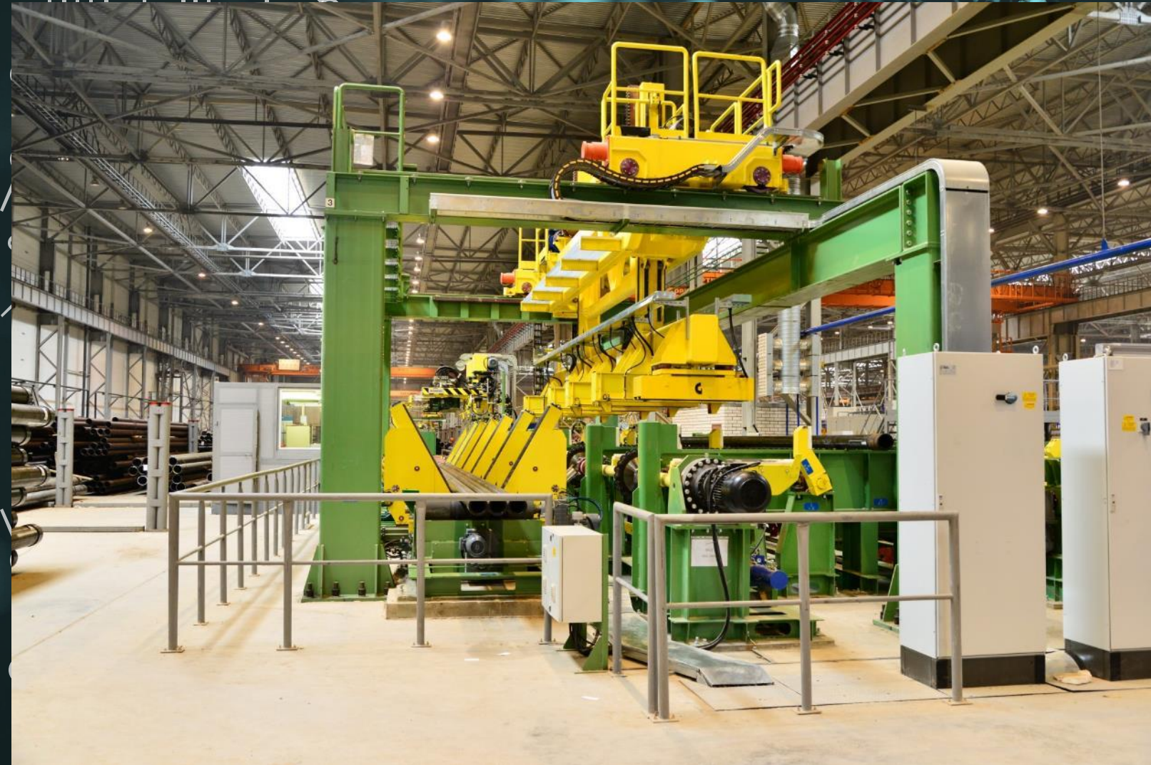
Установка пакетирования труб.
