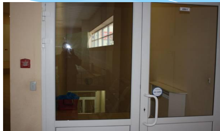
Дверь в коридоре оборудованы магнитным замком открывающимся с помощью электронного ключа
