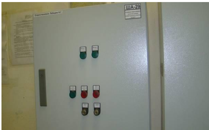
Система дымоудаления находится в неисправном состоянии
