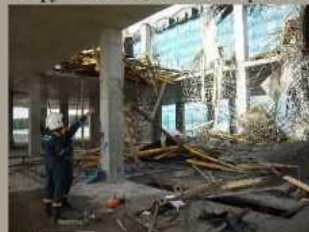
Обрушение здания на Урале
