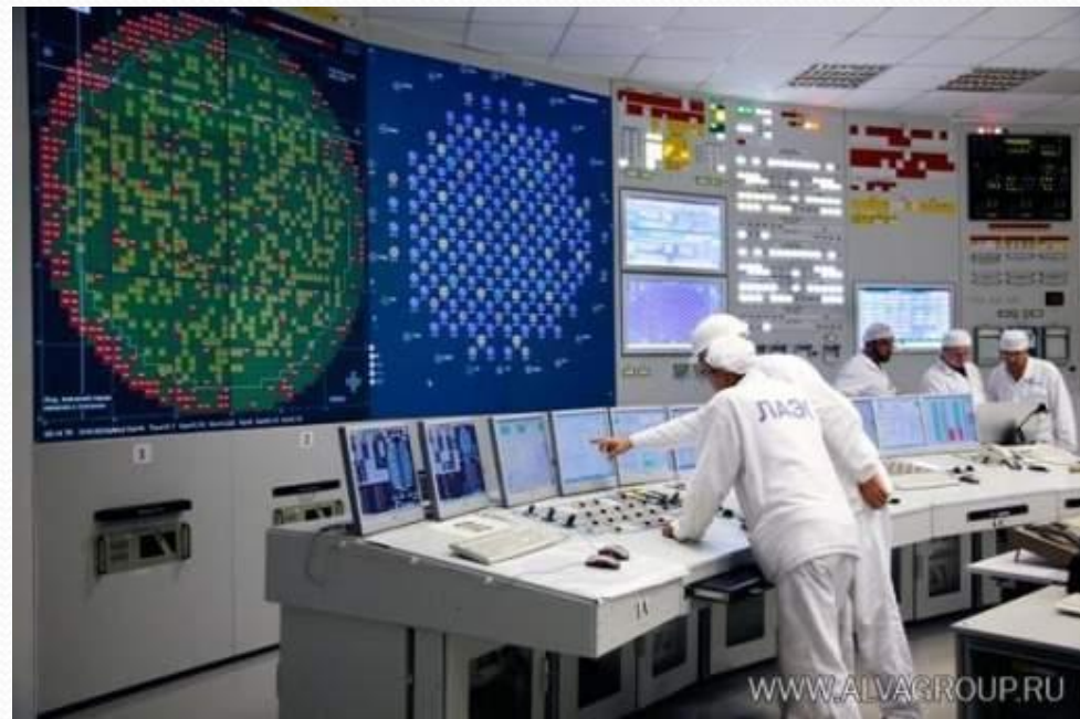
Ленинградская АЭС. Блочный щит управления
