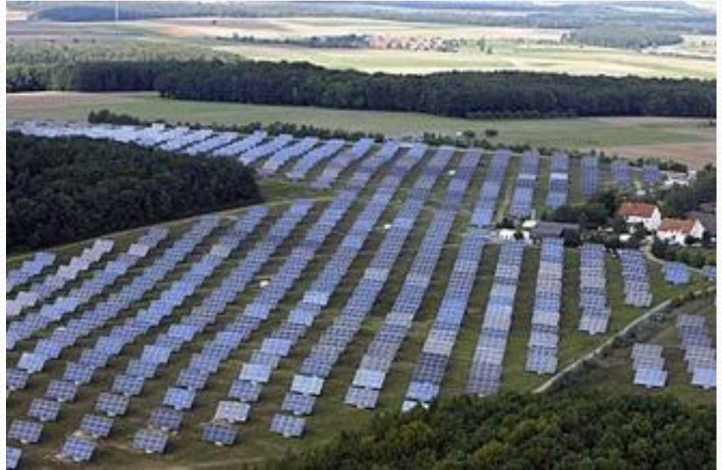
Солнечная электростанция в Германии
