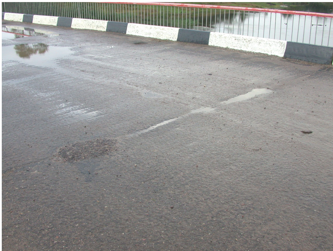
Рис. 3. Трещины в покрытии проезжей части моста в районе деформационного шва над опорой №4.
