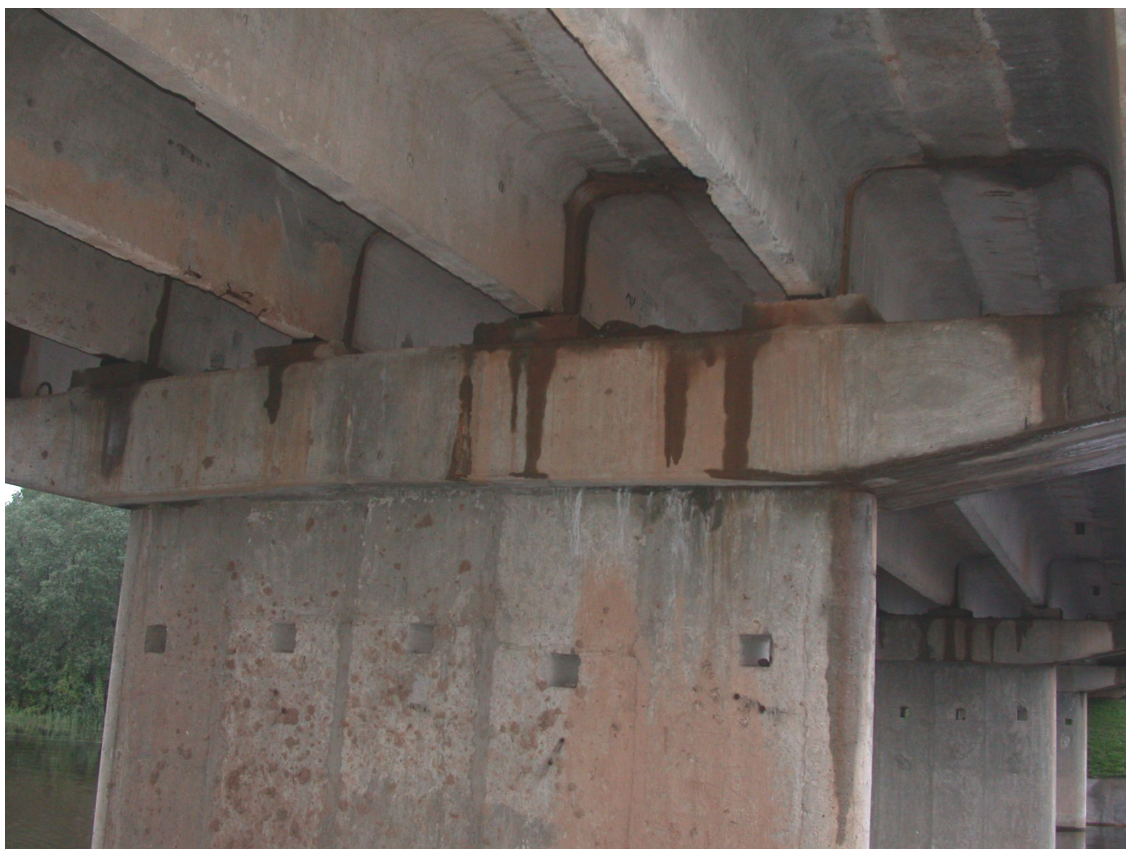
Рис. 14. Протечки по торцам балок и на ригеле опоры №4. Загрязнение поверхности ригеля.
