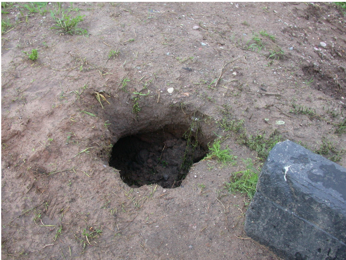
Рис. 15. Промоина на подходе №1 с левой стороны.
