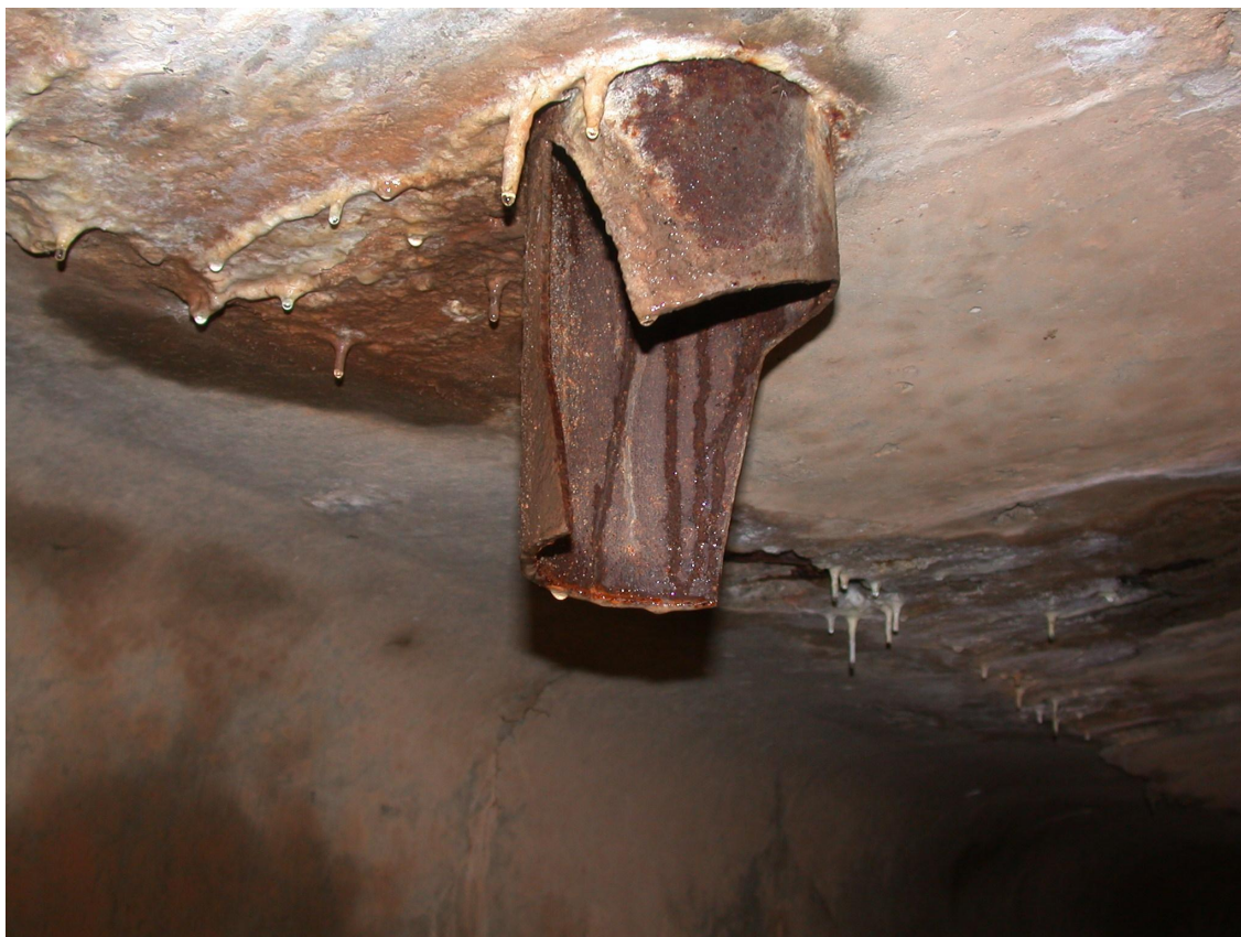
Рис. 7. Разрушена водоотводная трубка у балки Б6 в пролете №4. Недостаточная длина водоотводной трубки, коррозия металла. Протечки, выщелачивание бетона, сталактиты в шве омоноличивания балок.
