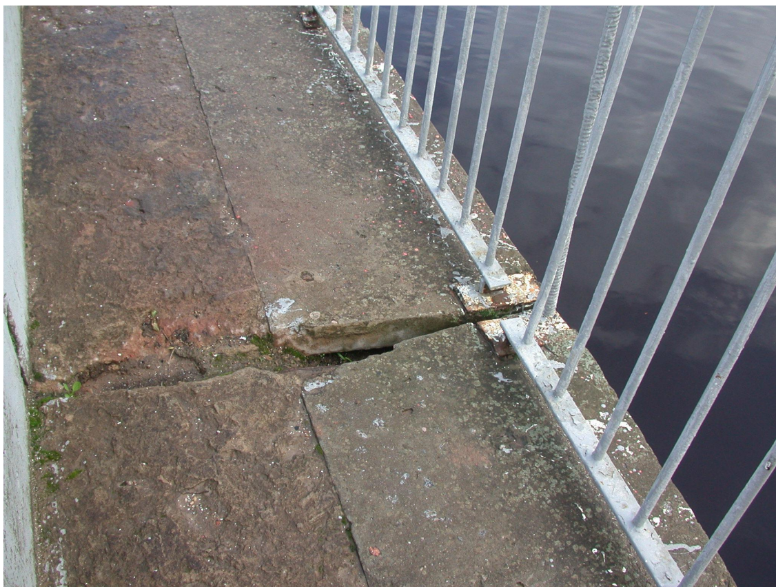
Рис. 6. Скол бетона в тротуарном блоке Т1 над опорой №2. Износ покрытия.
