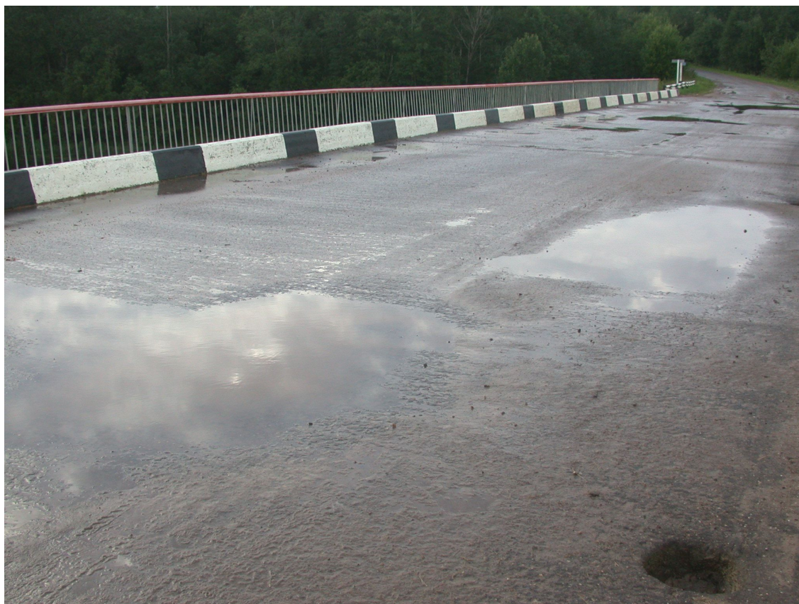
Рис. 4. Сверхнормативная толщина асфальтобетонного покрытия проезжей части на мосту. Образование луж.
