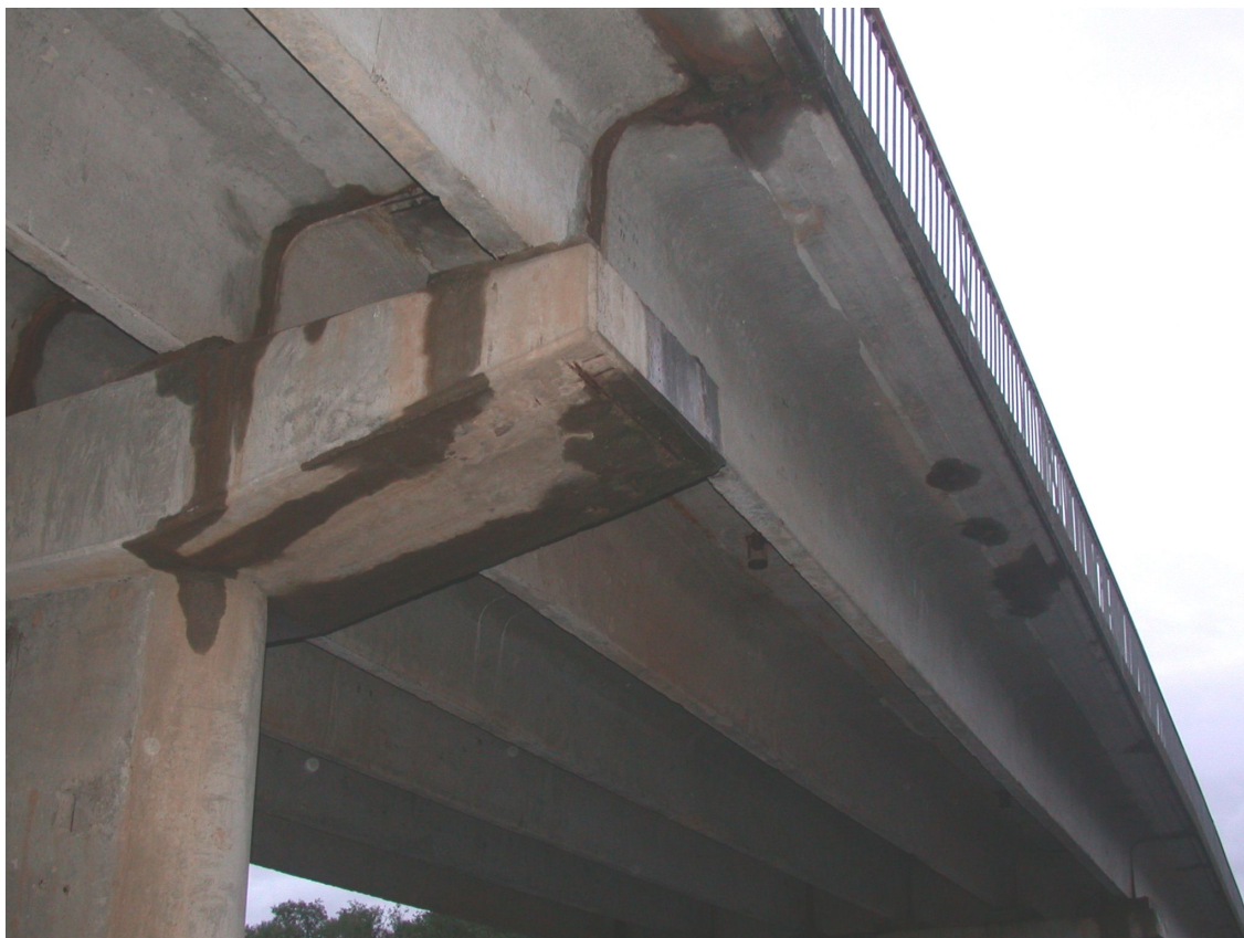
Рис. 13. Разрушение защитного слоя бетона с обнажением арматуры в ригеле опоры №2 с правой стороны снизу. Протечки в ригеле, в консолях и по торцам балок.
