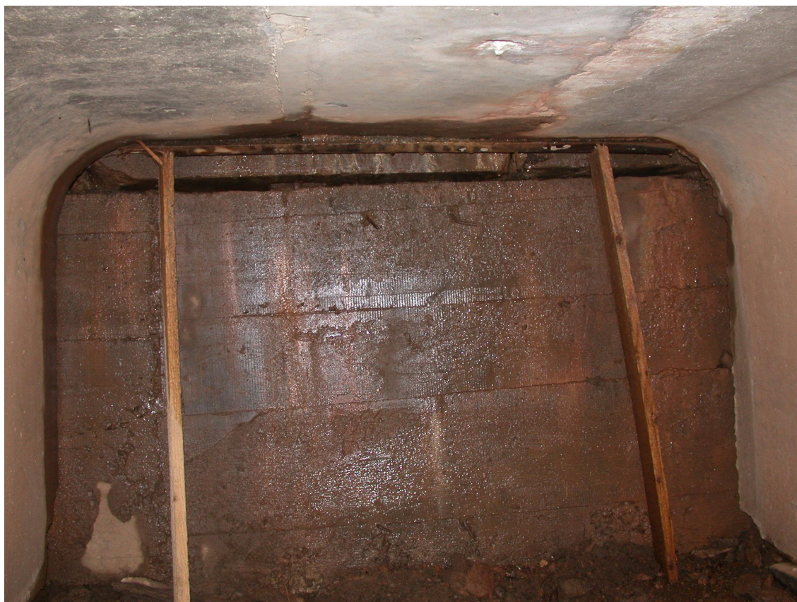
Рис. 12. Протечки на шкафную стенку опоры №1.
