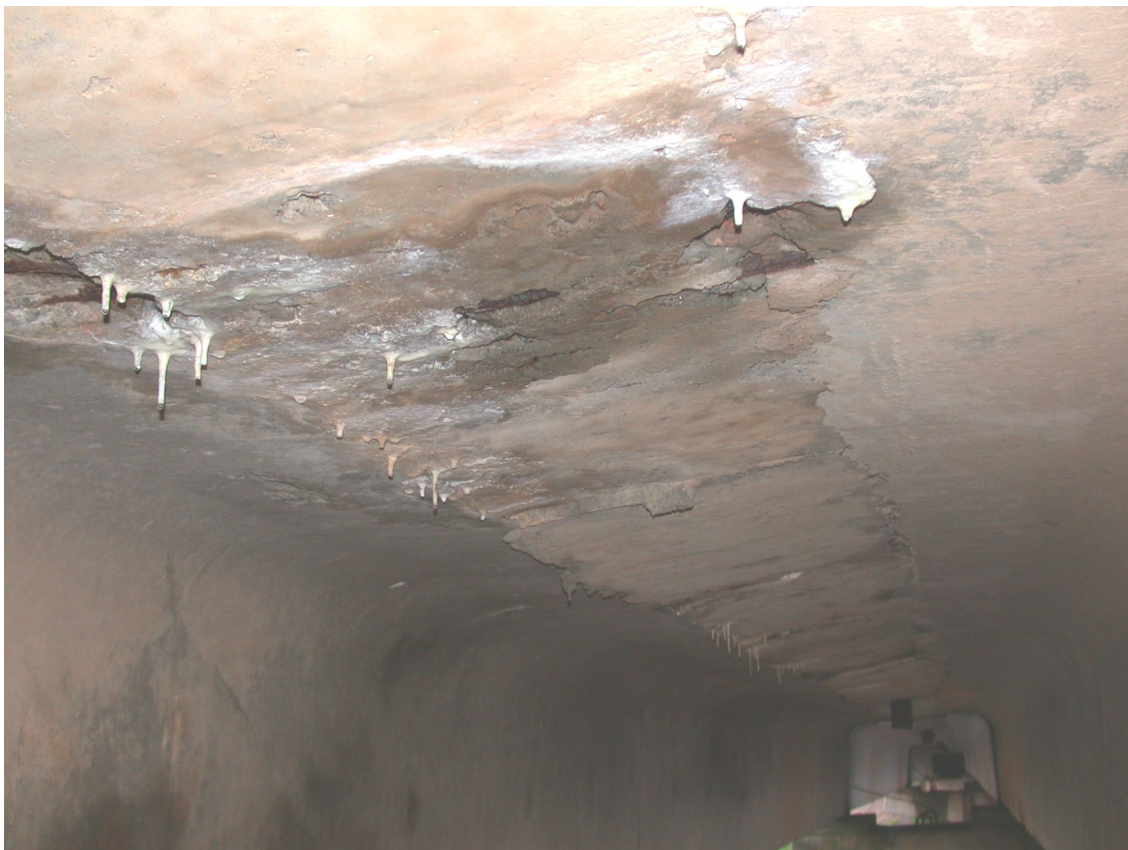
Рис. 9. Протечки, выщелачивание бетона, сталактиты в шве омоноличивания балок Б5 и Б6 в пролете №4. Разрушение защитного слоя бетона с обнажением арматуры.
