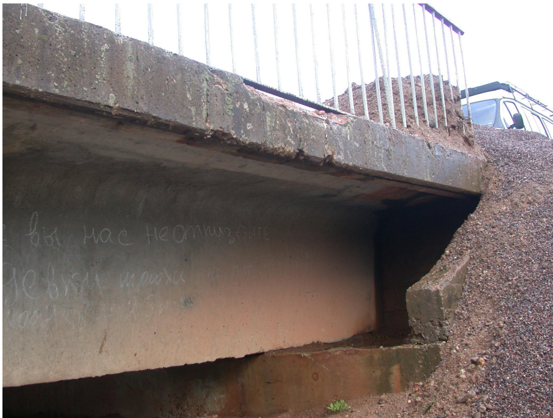
Рис. 5. Сколы бетона в тротуарном блоке у опоры №5 с правой стороны. Протечки по фасаду.
