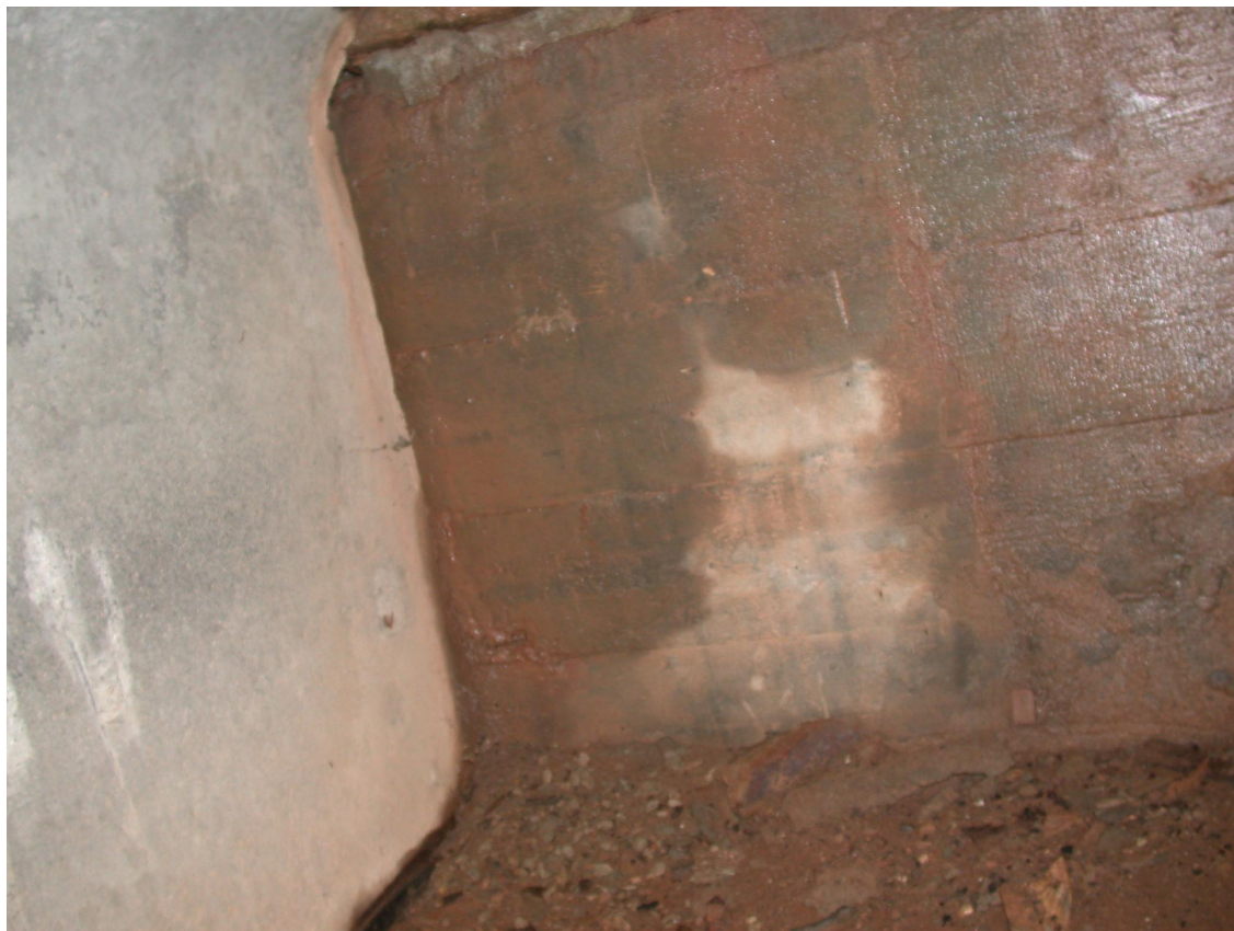
Рис. 11. Отсутствие температурного зазора в балке Б5 на опоре №5. Протечки на шкафную стенку, загрязнение ригеля.
