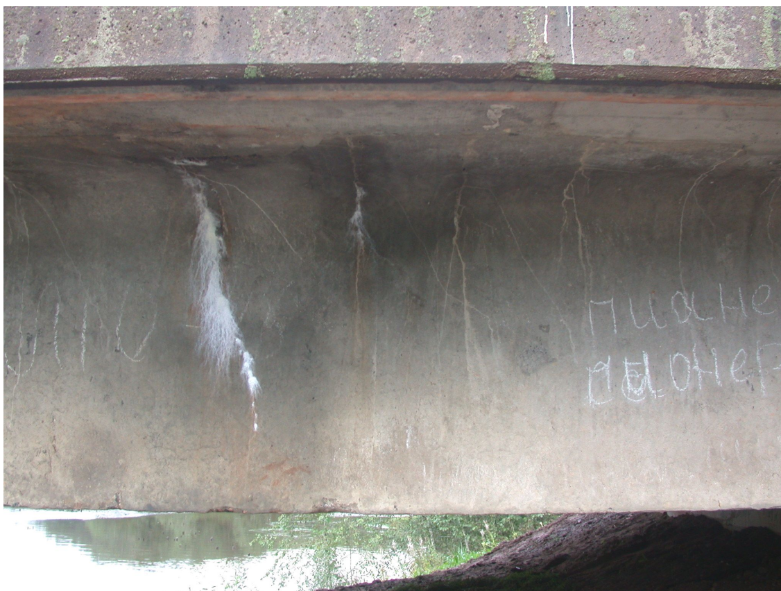
Рис. 8. Трещины по фасаду ребра балки Б6 в пролете №4. Протечки, выщелачивание бетона.
