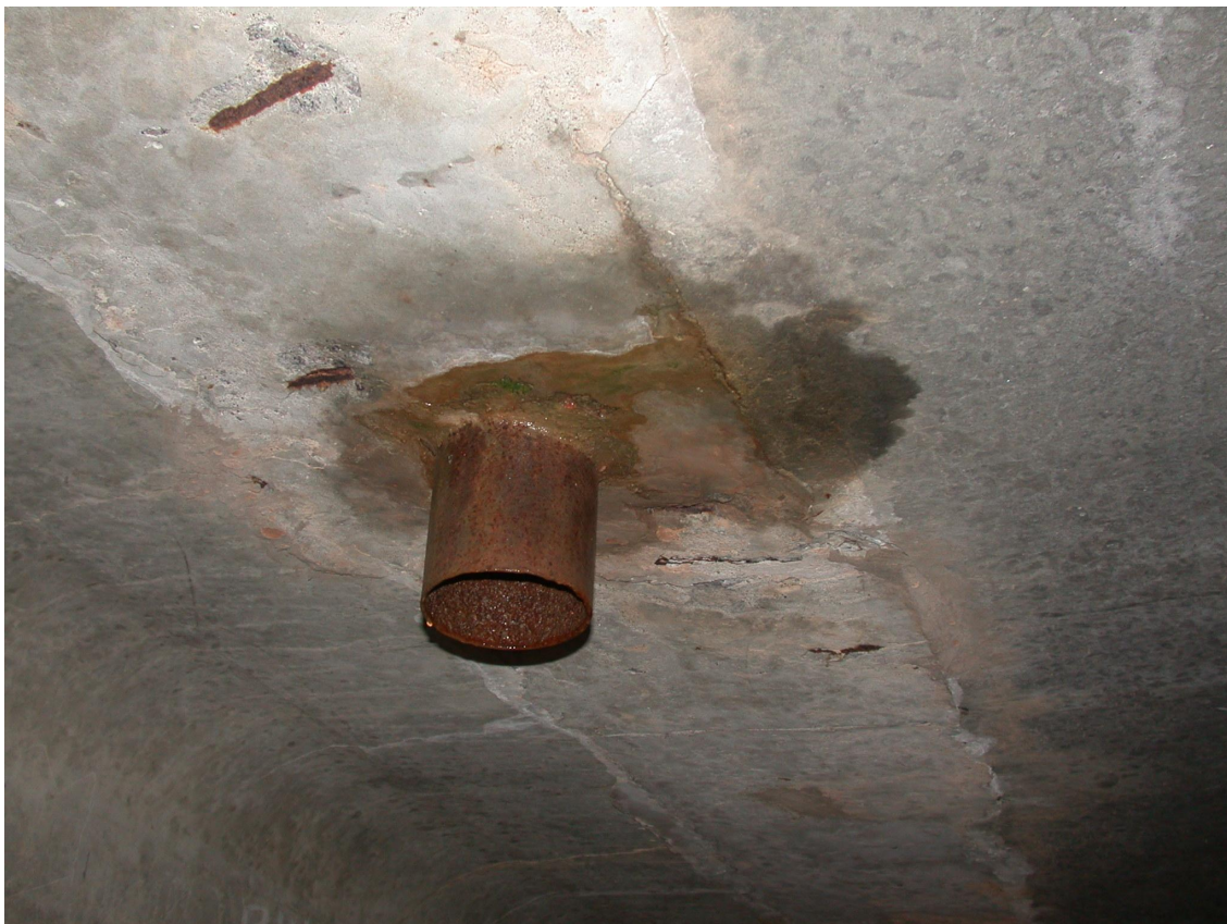
Рис. 10. Разрушение защитного слоя бетона с обнажением арматуры в шве омоноличивания балок Б1 и Б2 в пролете №4.
