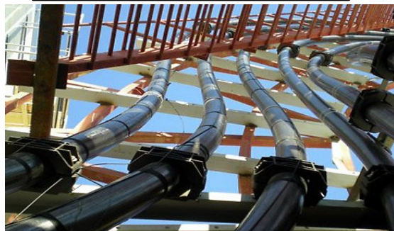
Владелец трубопровода Цех №2
