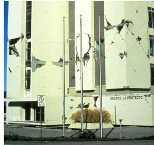
Рисунок 4.3 – Разрушение угловых и разнопрочных простенков
