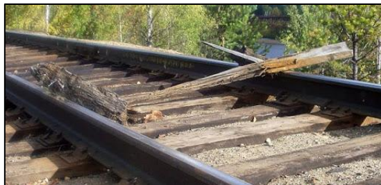
Посторонний предмет на пути
