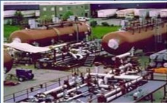
Рис.2. Электрообессоливающая установка фирмы Aker Kvaerner
