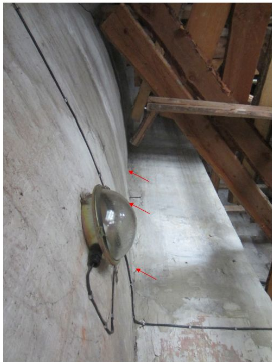
Фото 1. Интерьер северной пристройки. Трещины по непрерыванному сечению в местах примыкания угловой башни к основному белокаменному объему Золотых ворот.
