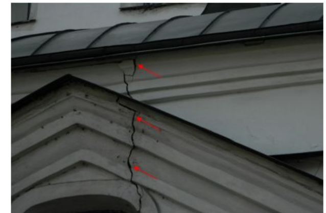
Фото 4. Фрагмент северного фасада, укрупненный вид верхней части пристроенного центрального объема. Последствия неравномерных осадок - субвертикальная трещина с шириной раскрытия до 20,0 мм в кладке карниза.
