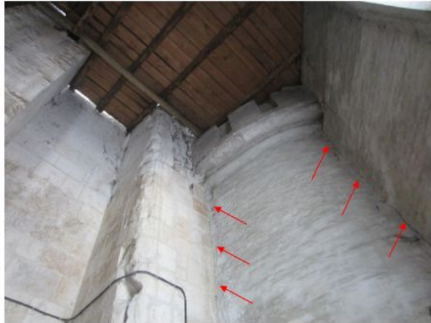
Фото 2. Интерьер северной пристройки. Трещины по неперевязанному сечению в местах примыкания стен пристройки к угловой башне, и угловой башни к основному белокаменному объему Золотых ворот.
