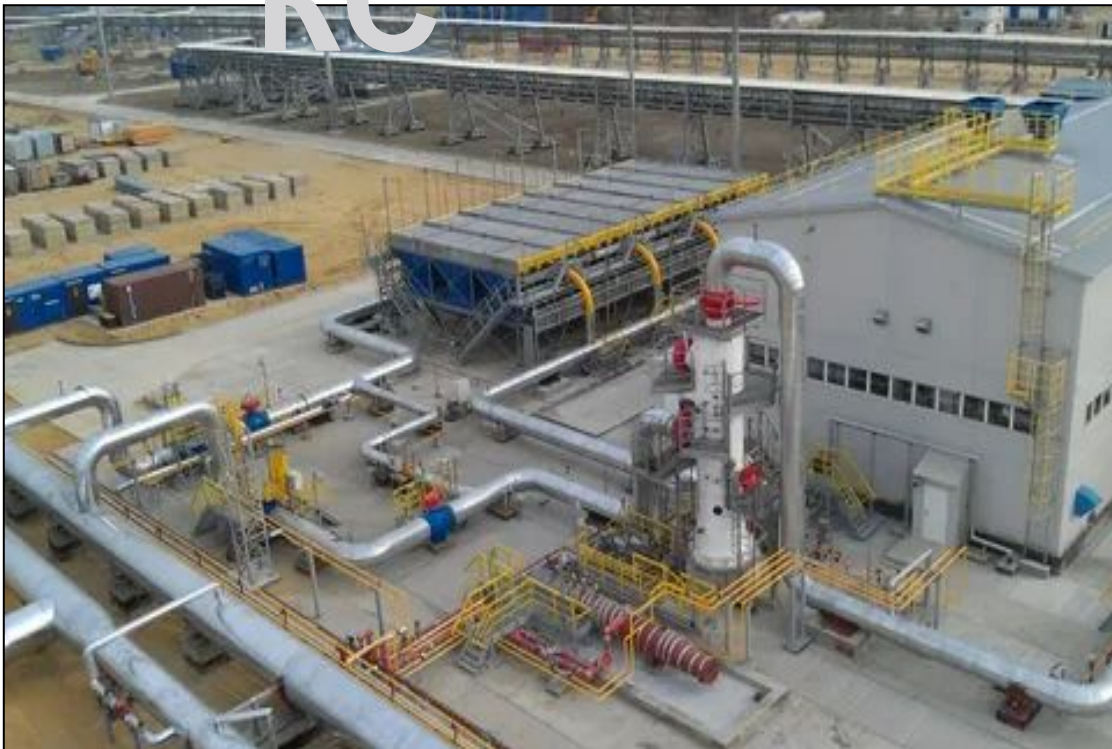
Головная компрессорная станция ГКС Саха лин.
