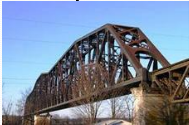
Мост, поврежденный коррозией.
