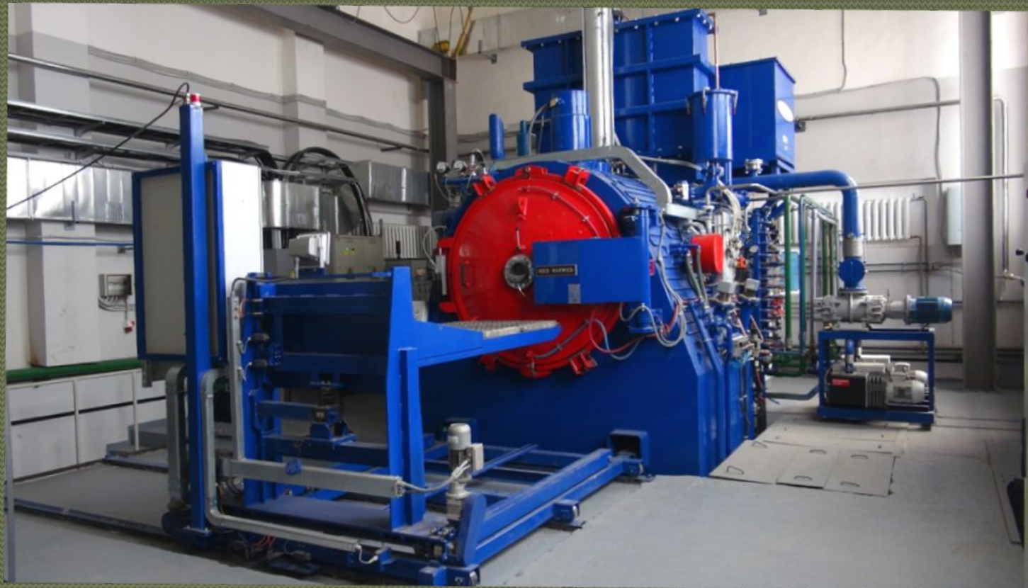
Вакуумная печь (Seco/Warwick) CMe D-12 в цехе ООО «СЦТ».
