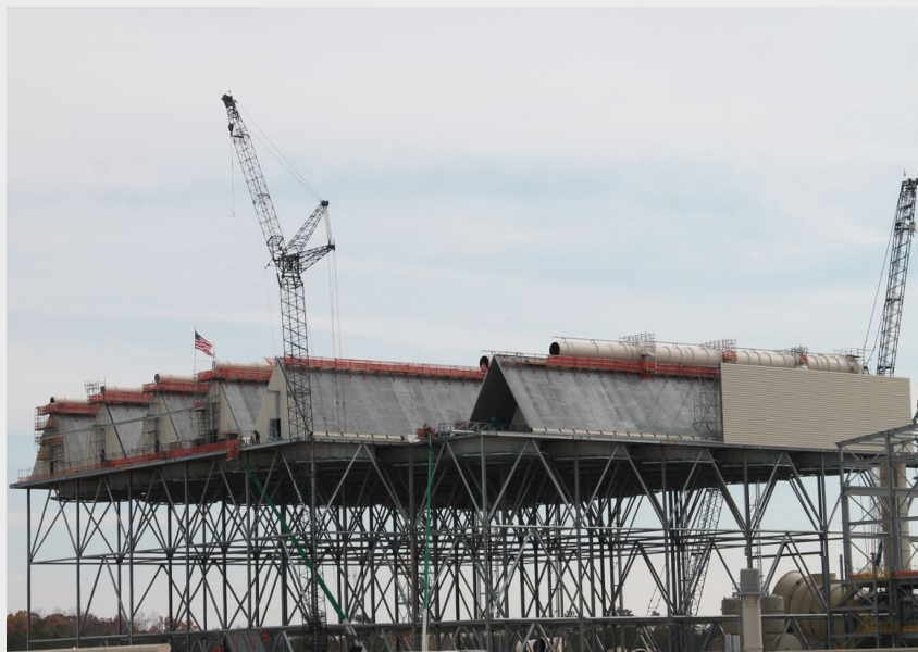
Рисунок 2 Воздухоохлаждаемые конденсаторы, установленные на электростанции в Северной Каролине
